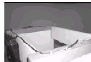
Прокладка Рис. 2-4д Общий вид подключенных кабелей
